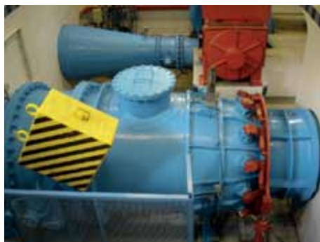
Waterkrachtcentrale Prad (Italië). Deze REScoop controleert de hele keten, van productie tot verbruik. (Ecopower)
